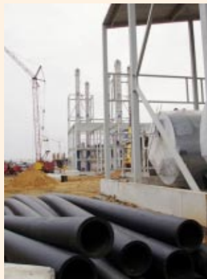
Применение ПЭ труб для систем водопровода, в том числе системы пожаротушения, при строительстве завода на Пулковском шоссе, Санкт-Петербург
