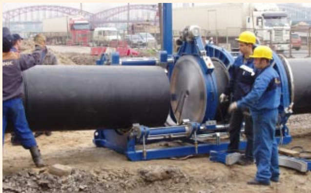
Санкт-Петербург, 2005 г. Сварка полиэтиленовых труб диаметром 900 мм проводится на надежном и современном оборудовании. Подобным оборудованием сегодня располагает большинство ведущих отраслевых строительных организаций.
